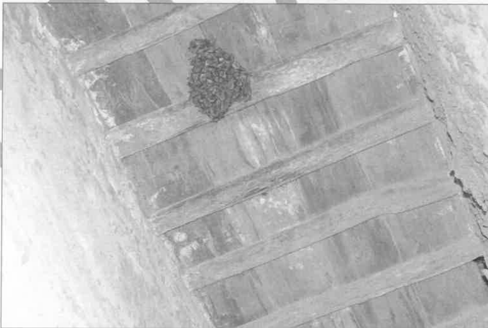
Localisation de la colonie de chiroptères à l'aplomb de la montée d'escalier.
